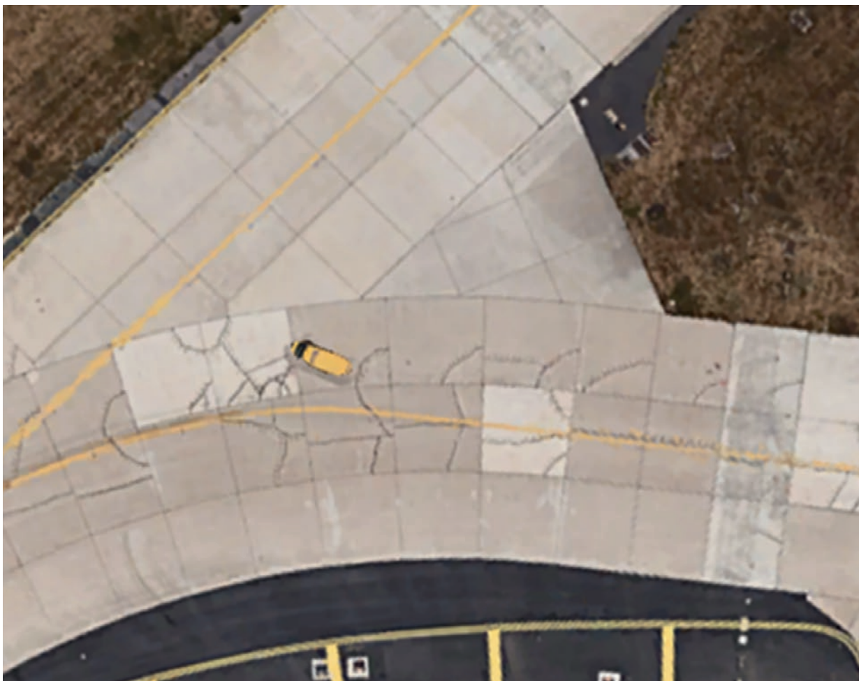
Le taxiway W42 nécessite des travaux pour assurer le déroulement des opérations en toute sécurité.
